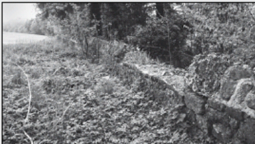
Abb. 8: Am höchsten Punkt der Klostermauer Himmerod auf der Ostseite ragen nur noch wenige Steinreihen aus dem Gelände, die Abdeckung aus dreieckigen Steinen ist teilweise beschädigt.
